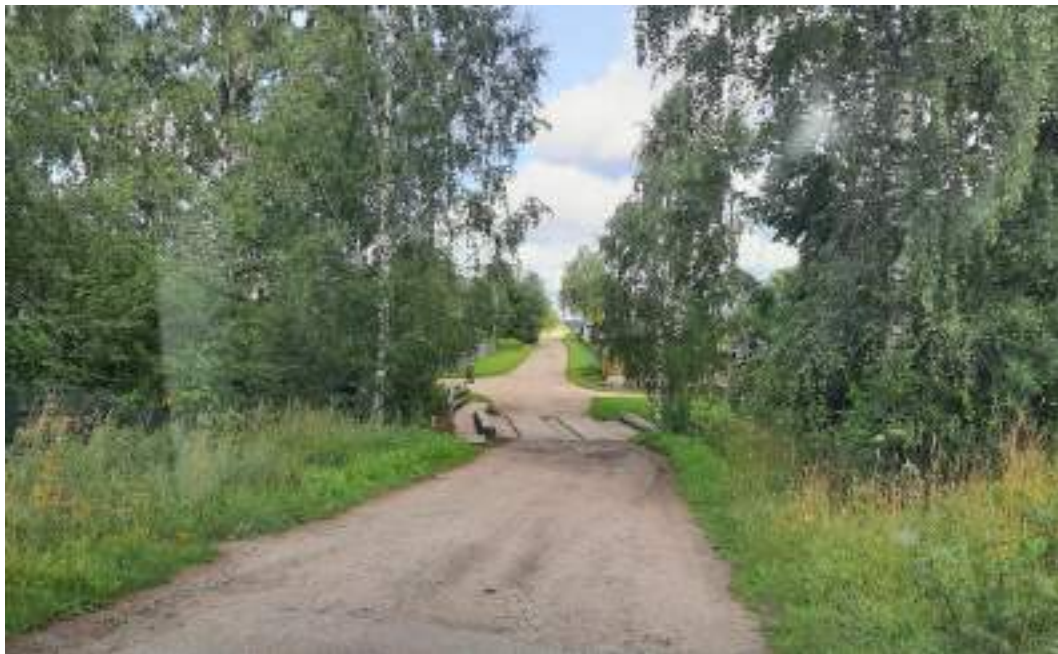
Рисунок 3.16 – Участок в д. Ион-горка в неудовлетворительном состоянии
