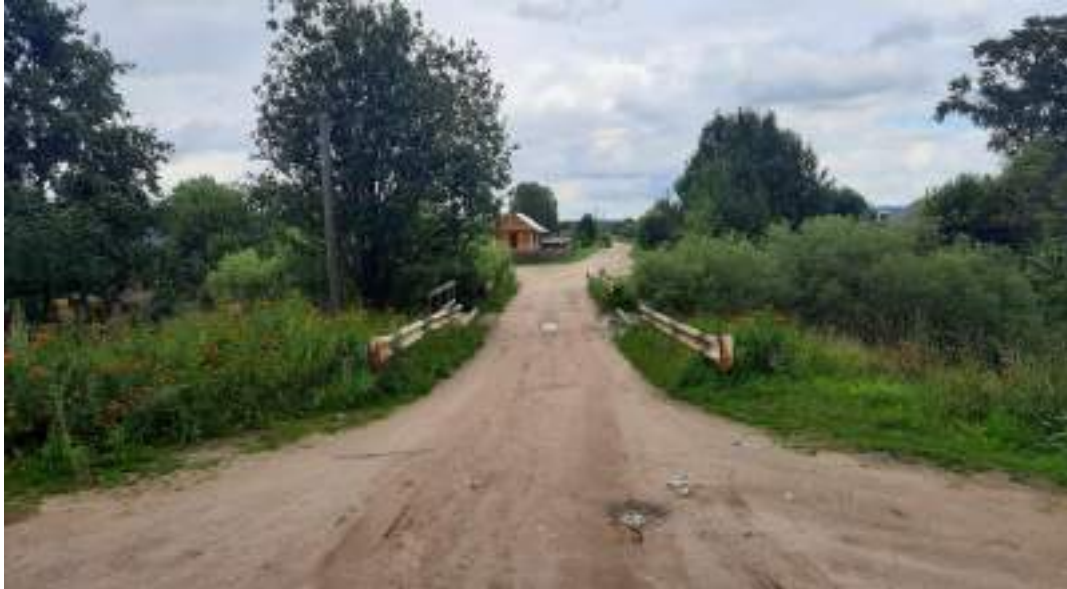
Рисунок 3.15 – Участок в д. Тарасоволоцкая в неудовлетворительном состоянии
