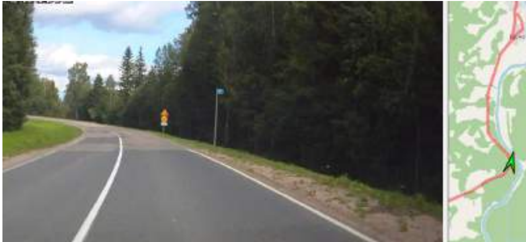
Рисунок 1.6 – Резкая смена качества дорожного полотна на автодороге 11К-792 между с. Березник и д. Едьма
